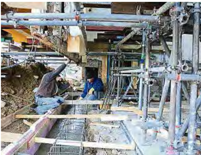
Schwebendes Hauseck: Die Außenwand wurde auf Zehnermetern mit Stahlträgern und Schwerlastgerüsten unterfangen, um die Betonarbeiten ausführen zu können.
